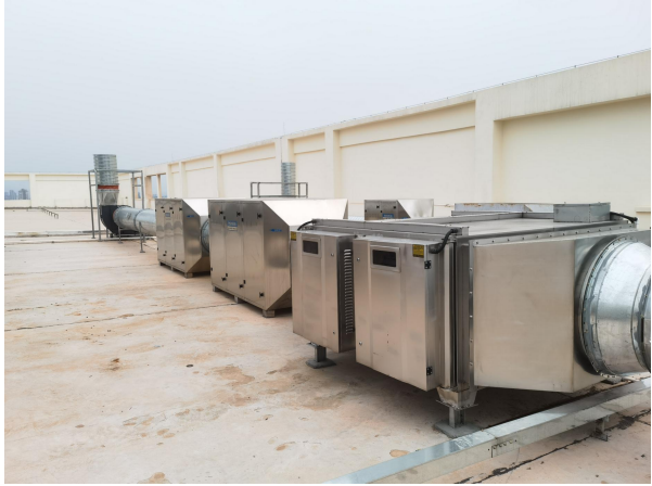
注塑废气净化治理设施 2# (FQ-002)
