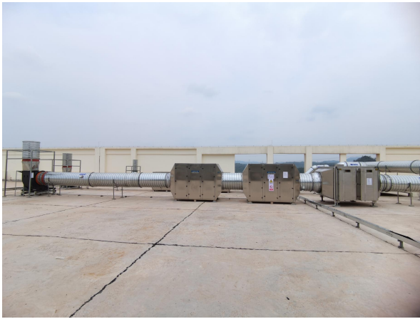
注塑废气净化治理设施 1# (FQ-001)
