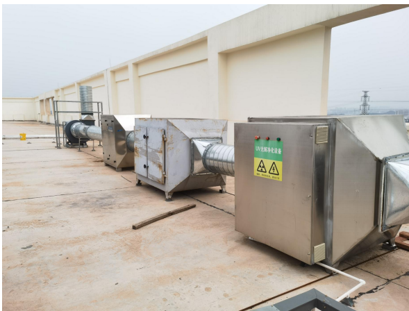
移印废气净化治理设施 (FQ-003)
