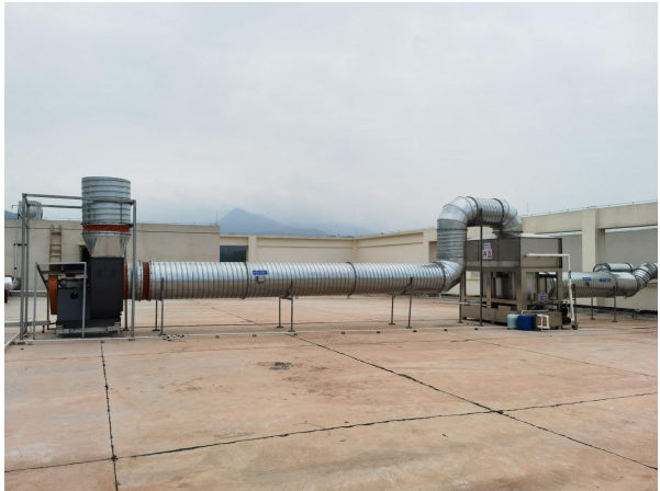
焊锡有机废气净化治理设施 1# (FQ-004)
