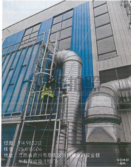
破碎废气 (出口)
