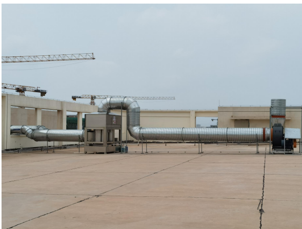
焊锡废气净化治理设施2# (FQ-005)
