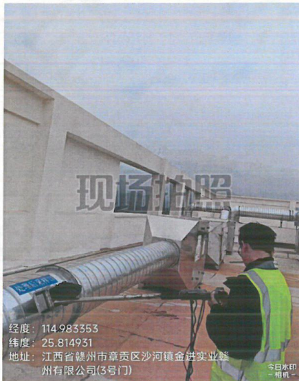
移印废气(出口)
